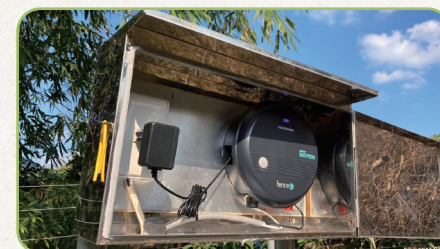
電牧器設置於防水白鐵電箱中
