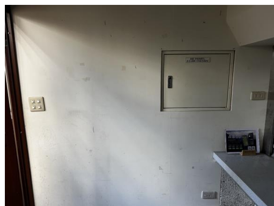
電源開關、電箱、內部櫃臺
