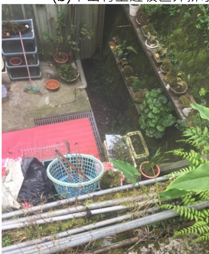
(d) 住宅後方水溝被鐵皮及雜物覆蓋
