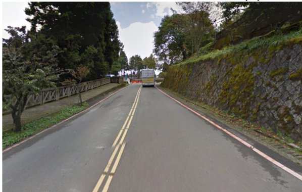
(b) 中山村上邊坡區外排水由路側溝排除
