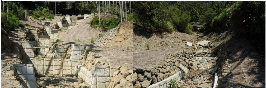
道路上方護岸
