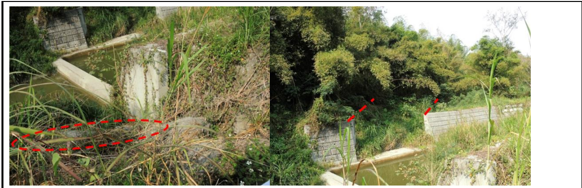
紅色標示處為陷落的排水涵管
